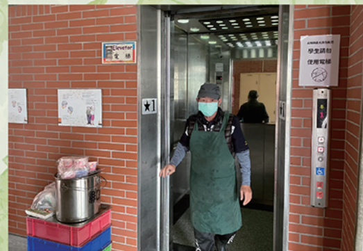
老舊電梯無法關閉及故障頻率增加
