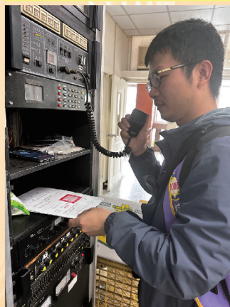
定期消防安檢
