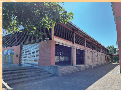
龍騰館隔柵鏽蝕嚴重需處理
