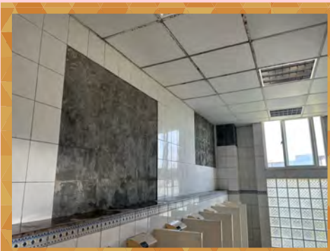
廁所磁磚修繕前
