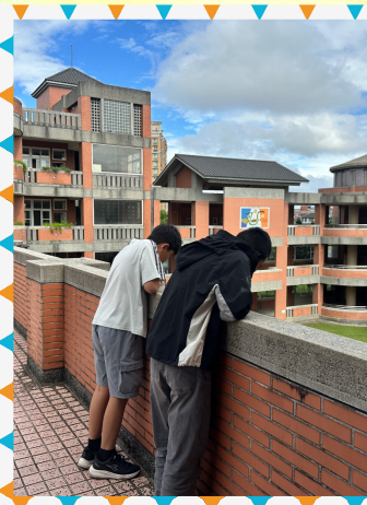
校舍女兒牆工程改善前照片
