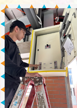
龍騰館電力改善完成驗收
