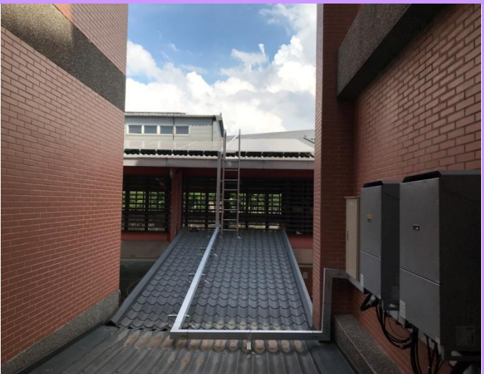
將電力回傳台電使用
